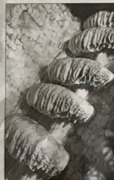
Une échelle en métal envahie par le calcaire. Photo ER/E.D.
