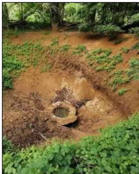
25/6/2021, 18 h : niveau d'eau au ras de la buse en béton (environnement autour un peu différent de celui des photos du 23, niveau maximal encore plus haut ?)
