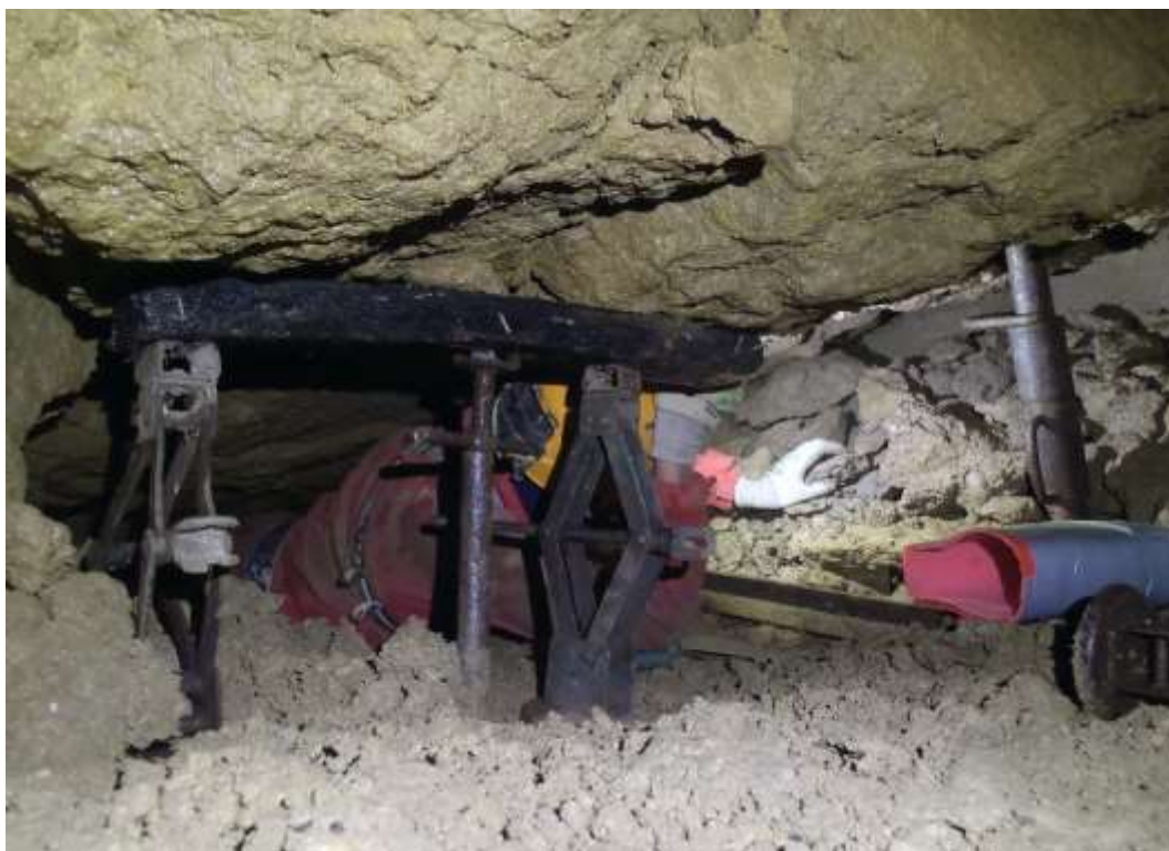
Consolidation de l'entrée du Fond de la Souche à Harmonville (88) (cliché : O. Gradot, 25/6/2021)
