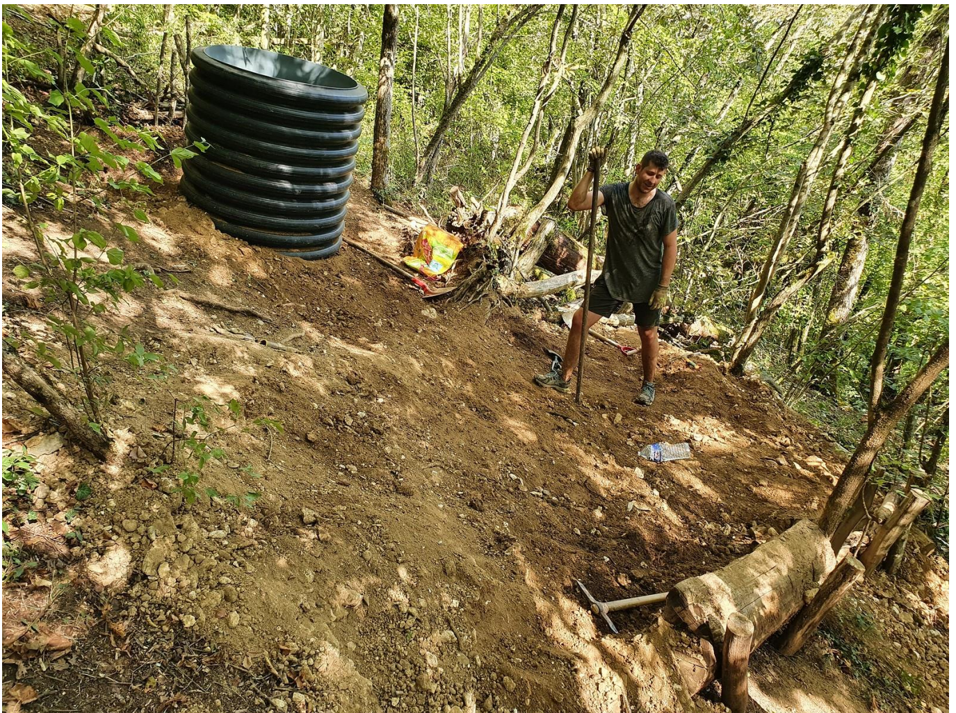
Busage du puits du Chouchen, Grotte des Sept-Salles, Pierre la Treiche (54), pose du deuxième tronçon (cliché : O. Gradot, 8 septembre 2023)
