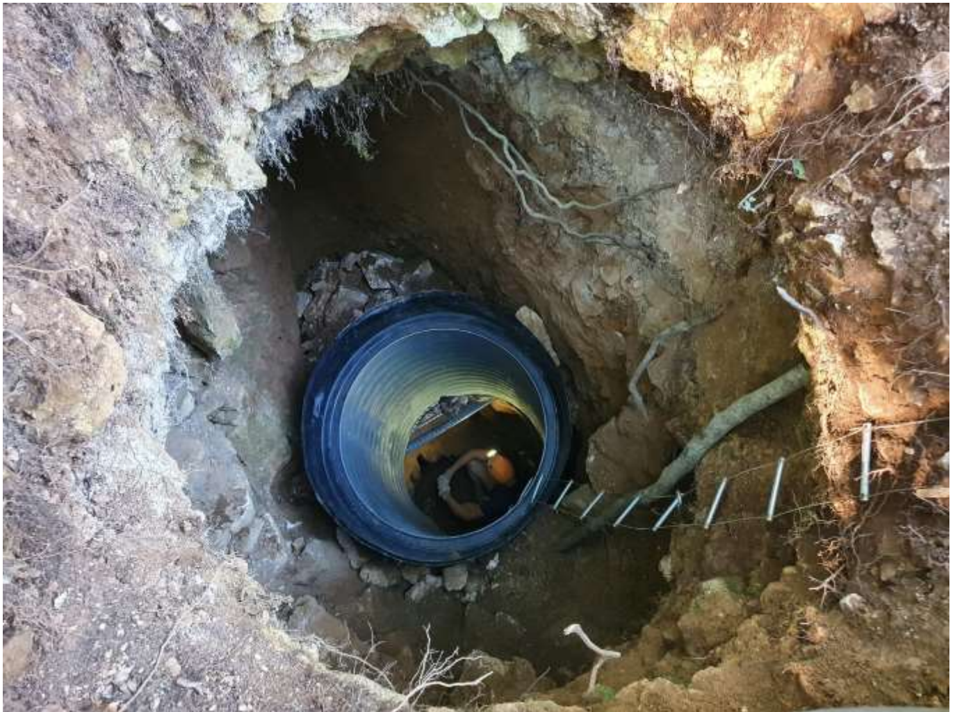
Busage du puits du Chouchen, Grotte des Sept-Salles, Pierre la Treiche (54), insertion du premier tronçon (cliché : O. Gradot, 20 août 2023)
